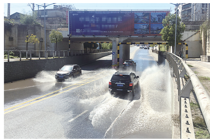
▲铁路跨白石港路涵洞积水未退。记者/刘平 摄
