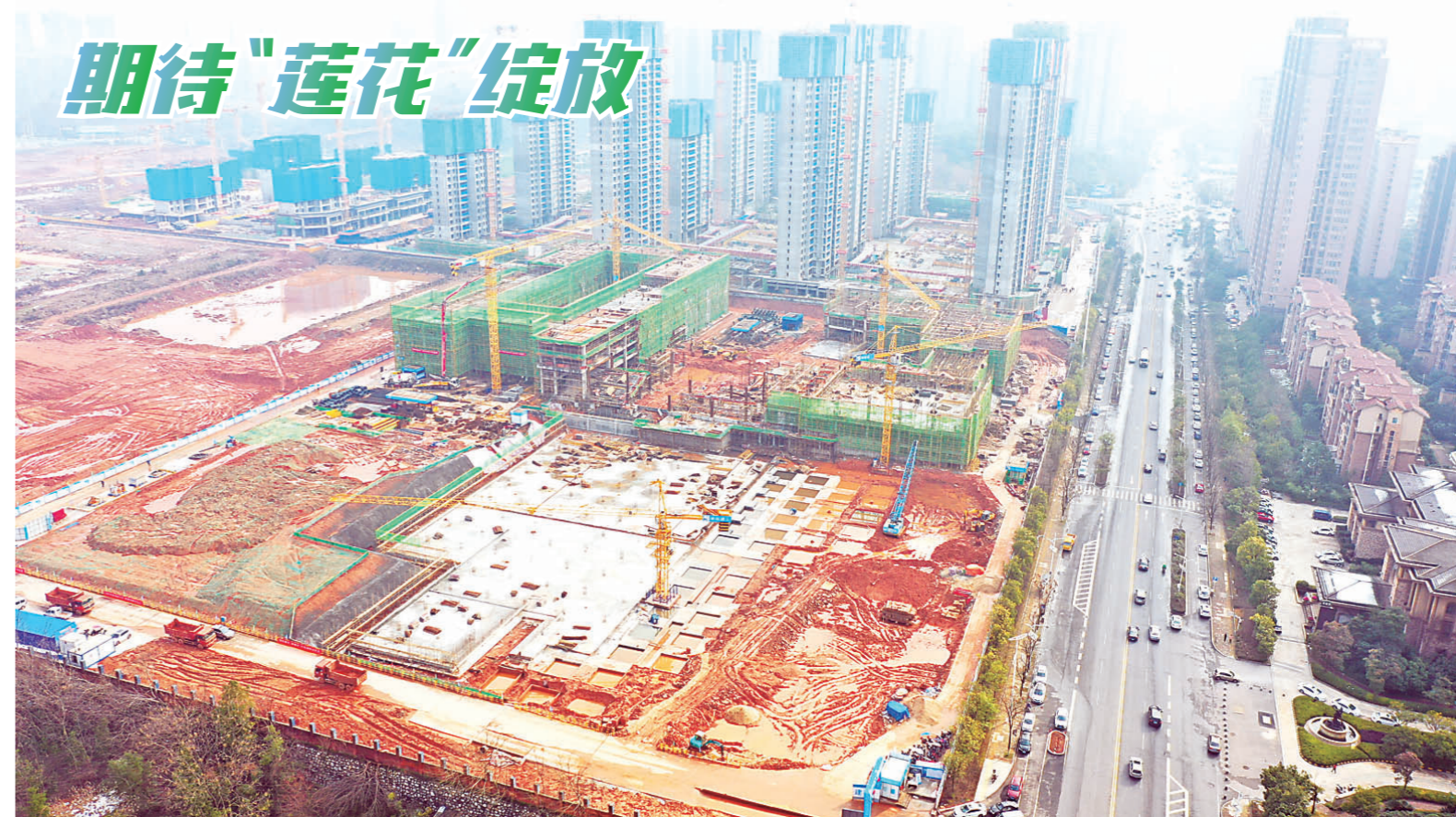
▲春节过后,莲花中学建设进入“加速度”。目前,主体工程已经完成80%,教学综合楼已建至五层,文体综合楼已到四层,行政综合楼已到三层,预计3月底主体工程全部封顶。 株洲晚报融媒体记者/谢慧 摄影报道
