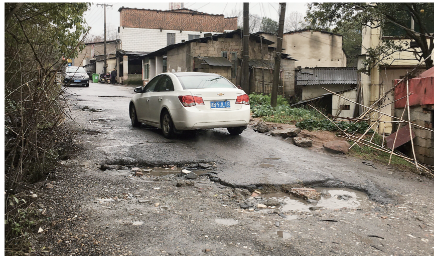
▲连接石峰大桥和新东路的便道破损不堪。记者/刘平 摄
