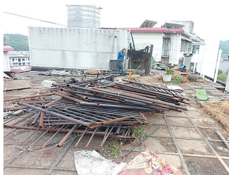
▲改造楼顶生锈的护栏。通讯员供图
