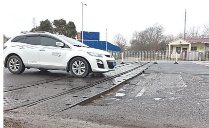
▲铁路道口已停用,路面破损。 记者/刘平 摄
