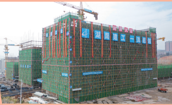
目前,湘南科创产业园第二批也正如火如荼建设当中,一个多月时间,2栋厂房已完成封顶。周峰 摄
