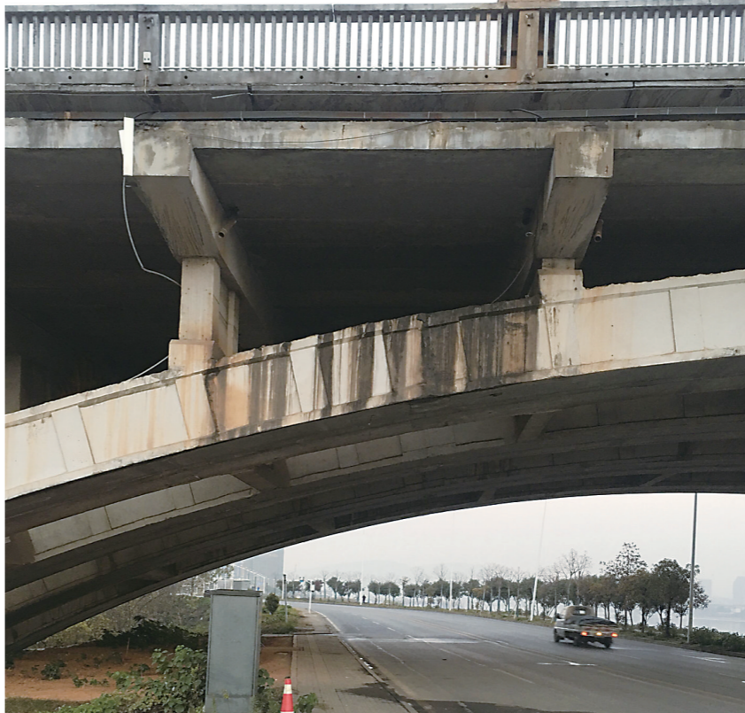
▲石峰大桥桥面排水管对着桥梁，桥梁上留有污渍。 记者/刘平 摄
