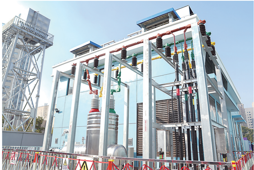
▲12月22日拍摄的超导电缆终端。新华社记者/丁汀 摄
