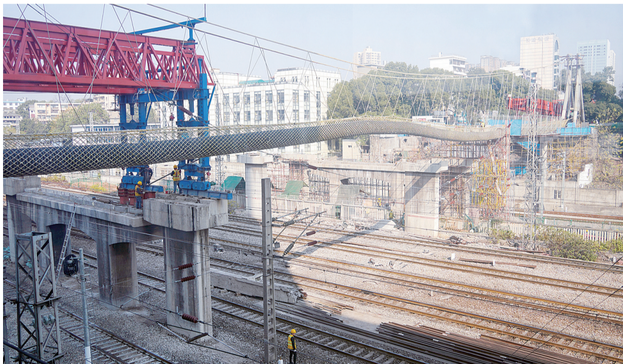
12月21日,随着新华桥最后一根梁被拆除吊离,新华桥全面进入重建阶段。株洲日报·掌上株洲记者/刘震摄
