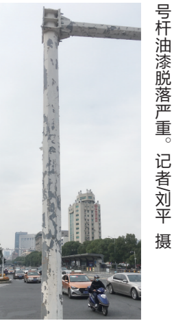
▲泰山路与长江南路交叉路口,交通信号杆油漆脱落严重。记者刘平摄
