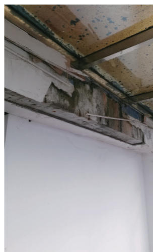
▲福鑫大厦楼顶渗水严重。记者/李逸峰 摄
