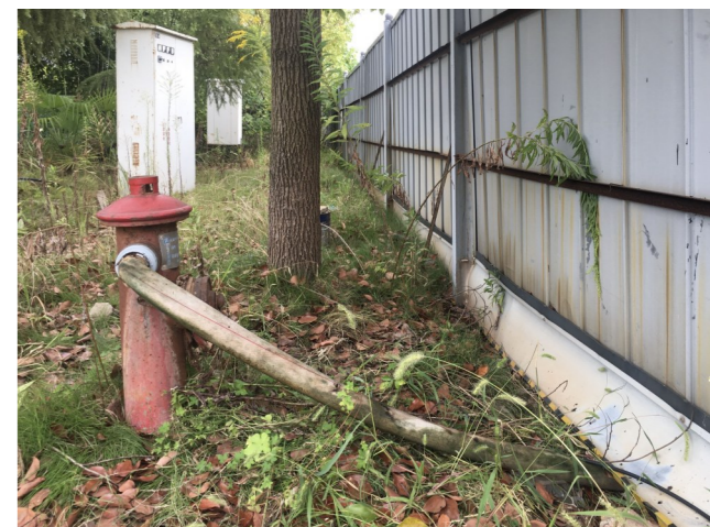
▲力嘉路边消防栓被违规取水。记者/刘平 摄
