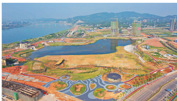
▲清水塘城市公园,正在进行东岸停车场与南岸停车场沥青摊铺、绿岛水榭条石铺贴、苗木养护、排渍站场站工程、配套用房装修、路灯穿线安装、给排水管网等施工。预计9月底具备开园条件。
