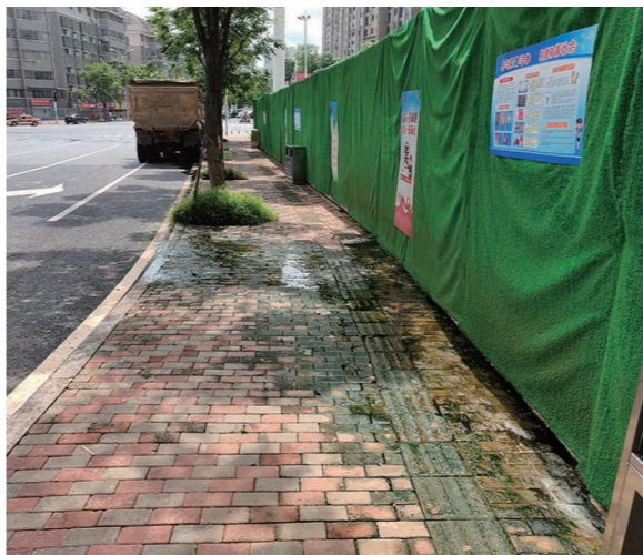
▲整改前,工地里渗出污水。记者/邱鹏 摄
