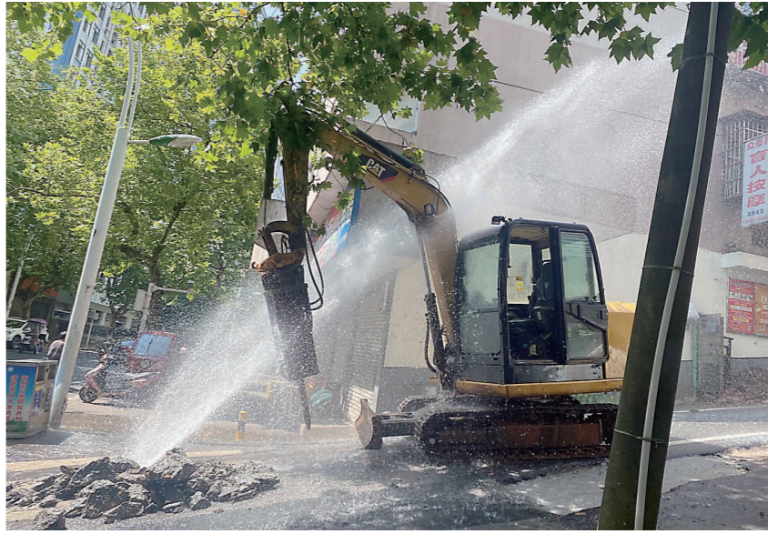
▲芦淞区人民中路DN450主供水管道被施工方挖坏。记者/易蓉 摄
