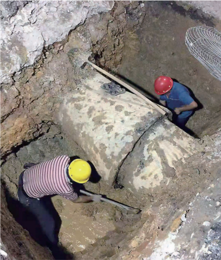
▲石峰区建设北路DN800主供水管道被挖坏,工人连夜带水抢修。记者/易蓉 摄
