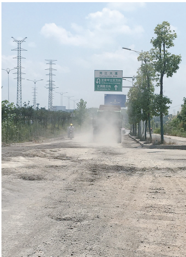
▲湘江大道辅道,路面坑洼,灰尘飞扬。
