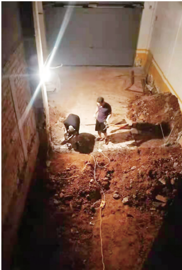
▲7月12日晚,门面内有人施工,地上有钢筋裸露。受访者供图
