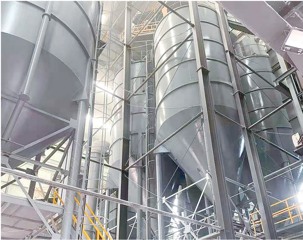
云龙强力新型建材有限公司预拌砂浆生产车间内的原材料储存仓。吴楚/摄
