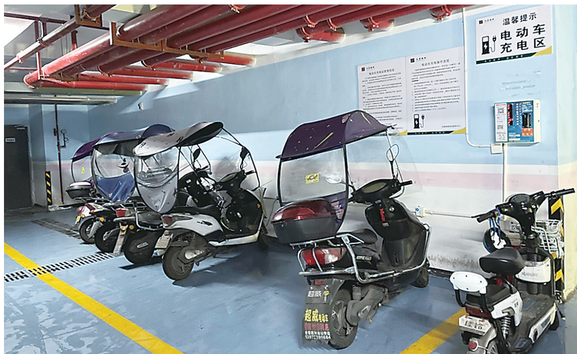
▲新建小区设置的电动车充电桩。株洲晚报融媒体中心记者罗欣摄
