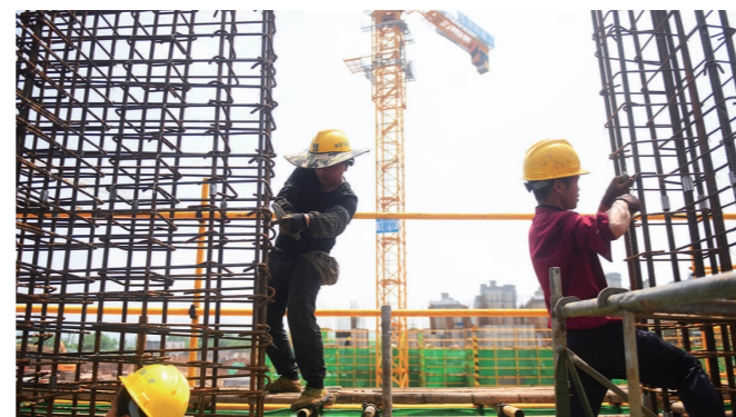
▲天元区一房产项目施工现场,建筑工人顶着烈日站在脚手架上捆扎钢筋。
