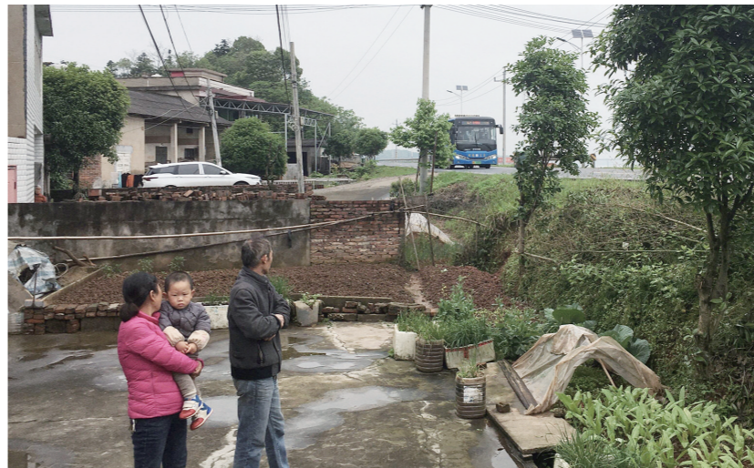
▲008县道霞石村古楼组路段,路边无护栏。记者 刘平 摄
