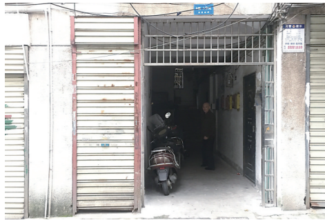
▲单元楼道里“建房”,原本3米宽的楼道剩下两米宽 记者 刘平 摄
