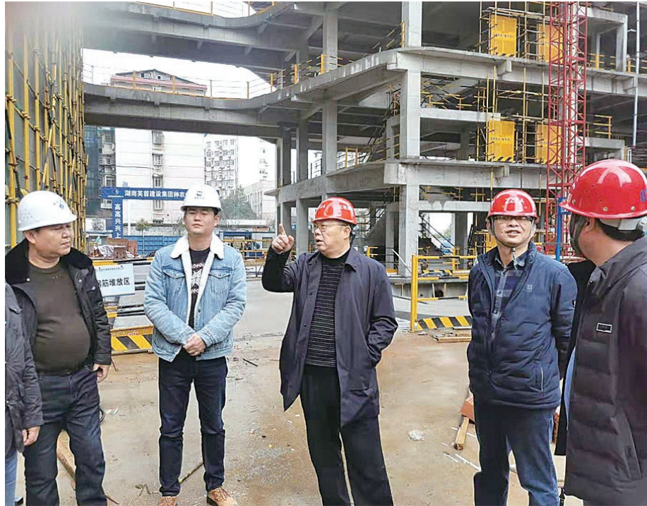
▲株洲市住建局党组书记、副局长谭智勇,株洲市质安站副站长邓少云带队检查神农大厦项目春节节后复工情况,提供复工指导服务,确保安全生产
