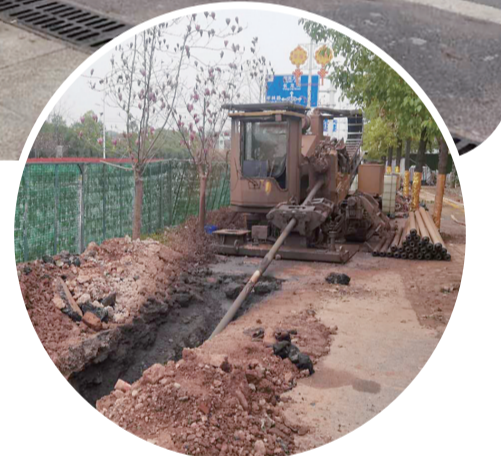
▲事发后,因燃气泄漏,施工人员撤离 廖喜张 摄
