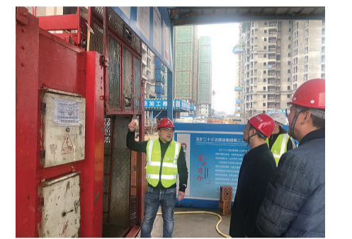
▲工作人员检查施工电梯检修情况 株洲晚报融媒体中心记者 周蒿 摄
