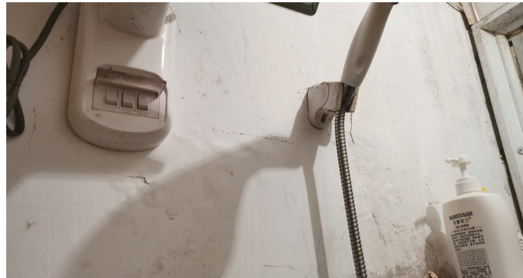
▲胡爹爹家卫生间的墙面大面积起鼓发霉 记者 姚时美 摄
