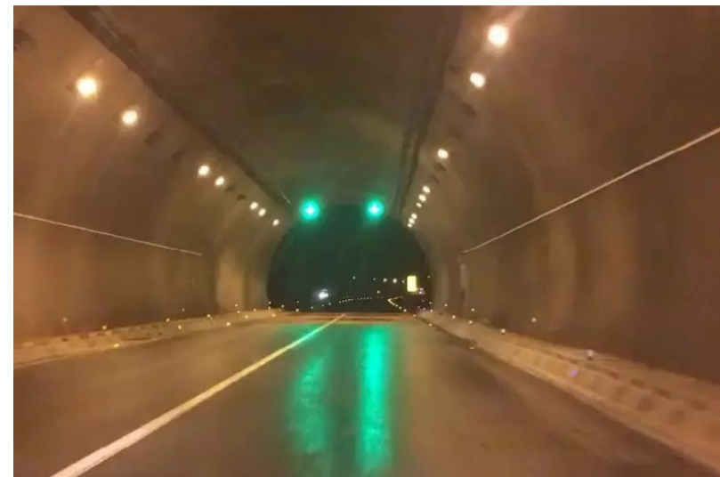
▲智能照明系统能提高路面能见度 通讯员供图
