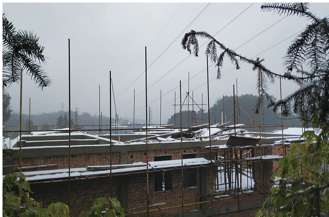
▲村民的房子还在建,房子下方就是高压线
