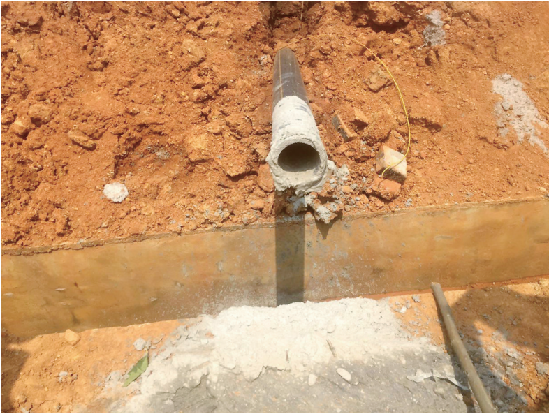
▲中油燃气铺设的管道被灌水泥
